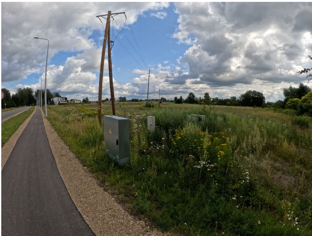
6.attēls. Skats uz detālpilānojuma teritorijā esošo elektrības sadalni
