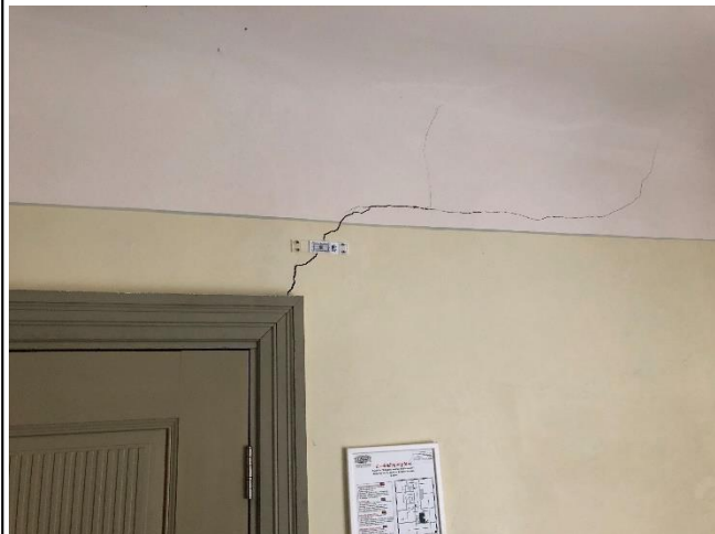
Foto Nr. 51 2.st. telpā nr. 38 uzstādīts noniusa plaisu lineāls
