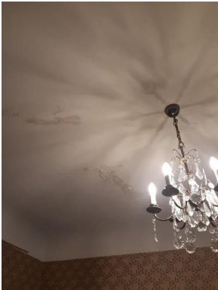
Foto Nr. 68 mitruma bojājums telpas nr.19 griestos
