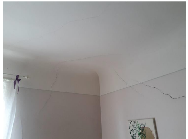
Foto Nr. 73 plaisu tīkls telpas nr.37 griestos
