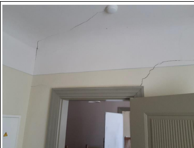
Foto Nr. 74 plaisu tīkls telpas nr.38 griestos
