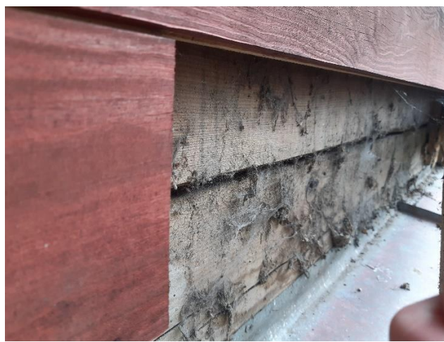
Foto Nr. 16 siena atsegums nr.2 Noprotezēti ārsienas balķi.
