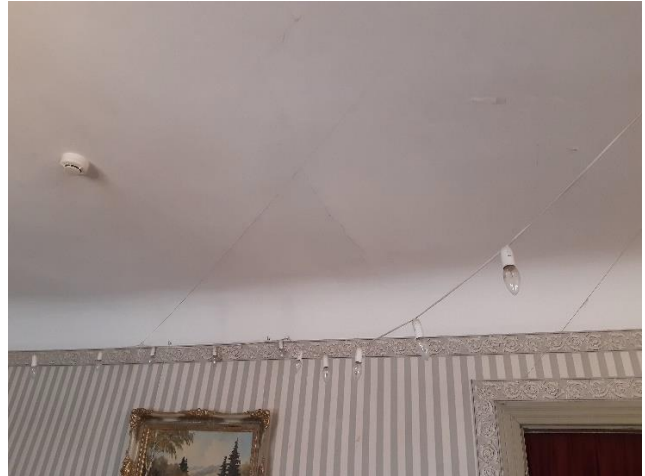
Foto Nr. 69 plaisu tīkls telpas nr.2 griestos
