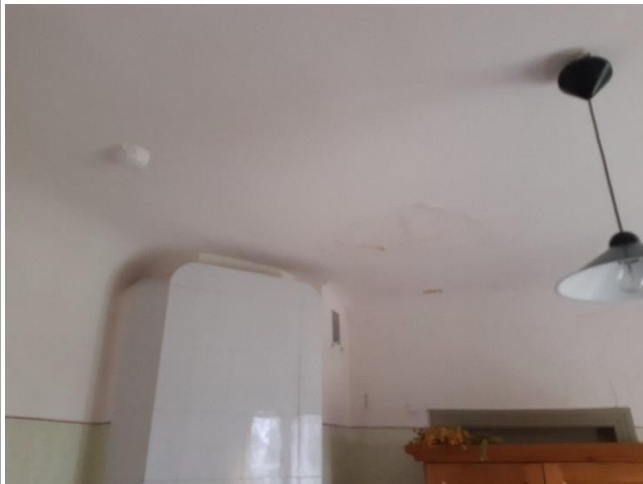
Foto Nr. 70 mitruma bojājums telpas nr. 34 griestos
