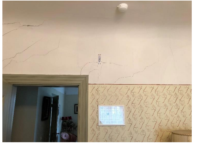
Foto Nr. 58 2.st. telpā nr. 23 uzstādīts noniusa plaisu lineāls
