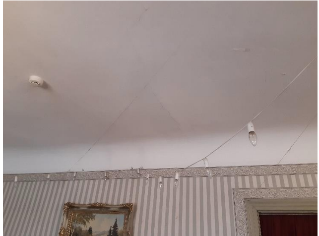
Foto Nr. 69 plaisu tīkls telpas nr.2 griestos
