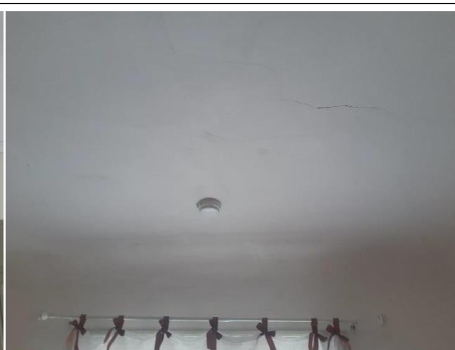
Foto Nr. 75 plaisu tīkls telpas nr.41 griestos
