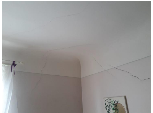
Foto Nr. 73 plaisu tīkls telpas nr.37 griestos
