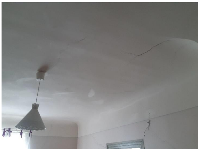
Foto Nr. 72 plaisu tīkls telpas nr.37 griestos
