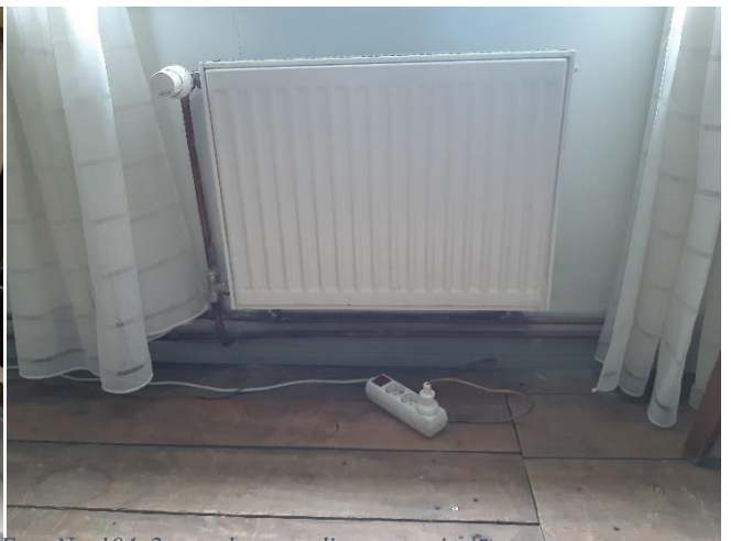
Foto Nr. 104 2.st. apkures radiators ar pieslēgumu
