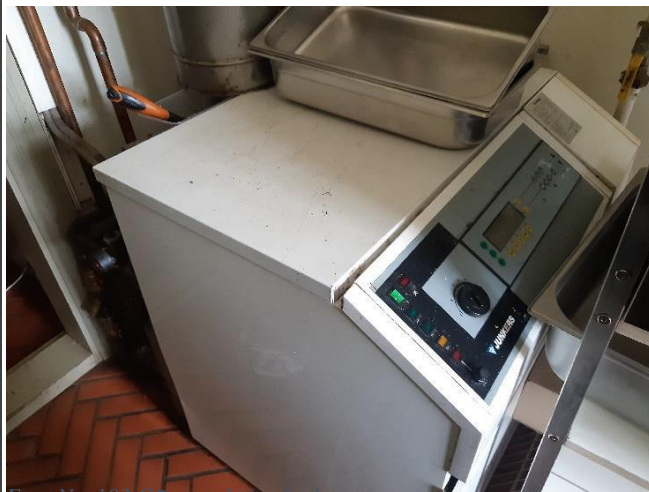
Foto Nr. 103 Gāzes apkures katls
