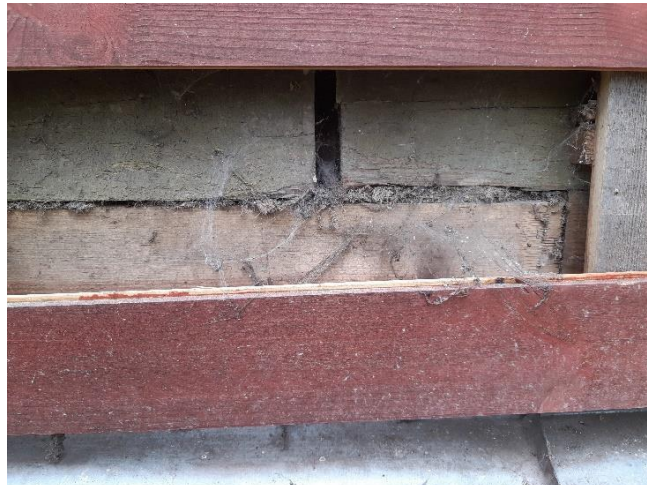
Foto Nr. 14 sienas atsegums nr.1 Noprotezēti ārsienas balķi.
