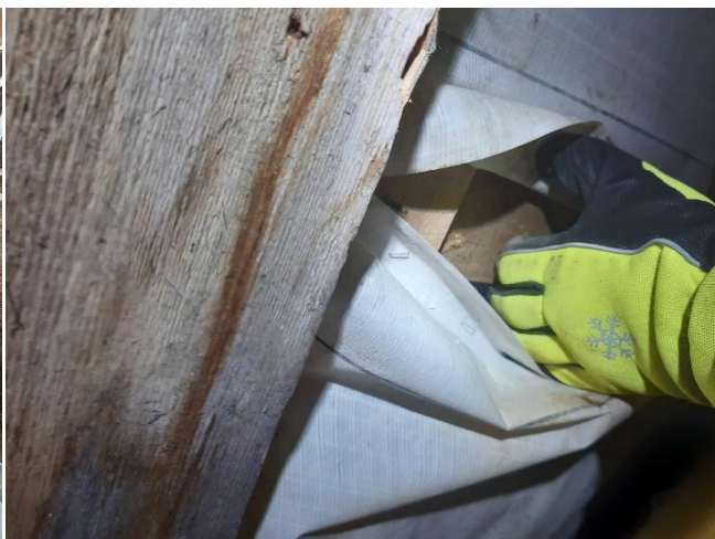
Foto Nr. 81 atsegums aiz jumta pārseguma siltinājuma
