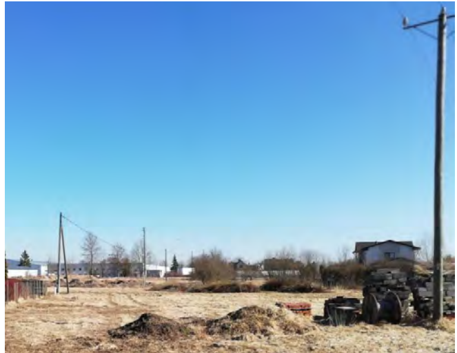
Fotofiksācija. 0,4 kV elektropārvades gaisvadu līnija un 20 kV elektropārvades gaisvadu līnijas balsts īpašumā "Āraiši"
