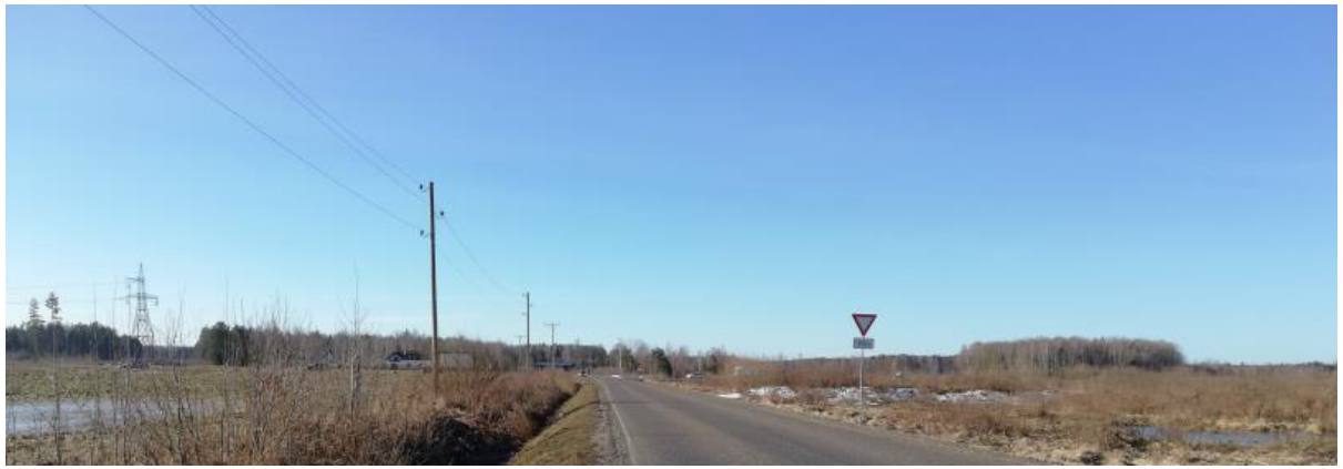
Fotofiksācija. Augstsprieguma elektropārvades 330 kV gaisvadu līnija, 20 kV elektropārvades gaisvadu līnija gar Ziemeļu ielu
